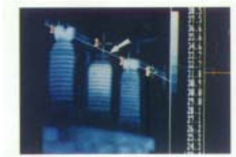
图 H17 110kV 电压互感器缺油
