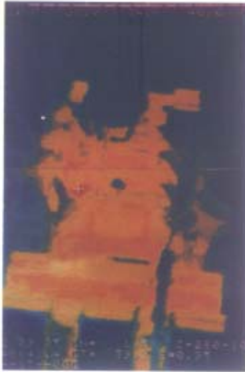
图 H6 变压器分接开关前接触不良，引起箱体顶部发热
